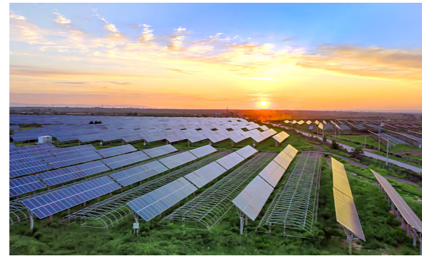
中国石化首个集中式农光互补发电项目 ——陕西省白水冯雷光伏项目
